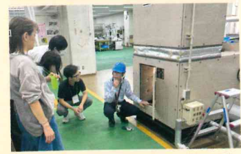
ビルの空調について、実際の設備を見学することで理解が深まりました。
